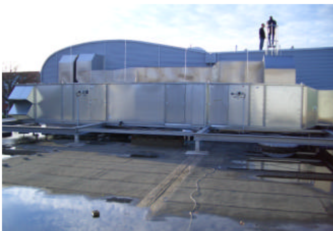
Lüftungsgeräte für Dachaufbau
