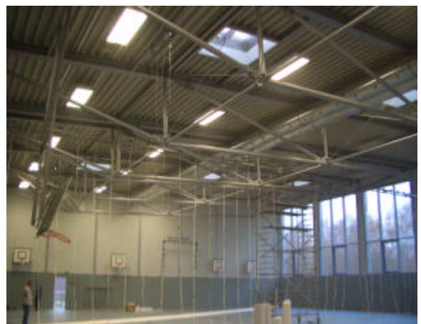
Zuluft Halle, Weitwurfdüsen
