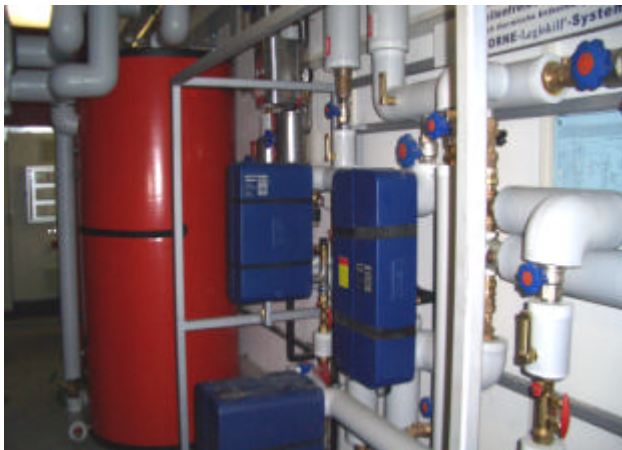
Warmwasserbereitung mit thermischer Desinfektion
